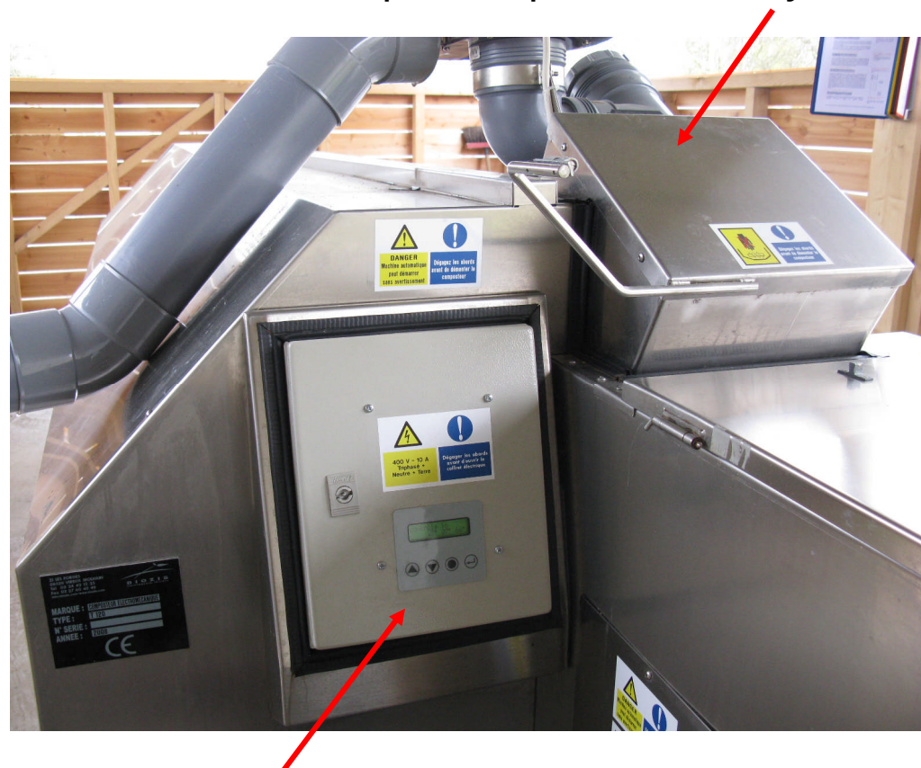
paramétrage du composteur et contrôle des paramètres
