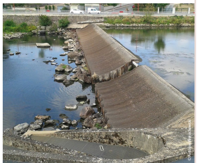
Barrage équipé d'une passe à poissons (au premier plan) et d'une vanne de vidange (au milieu) sur l'Arroux (71).
